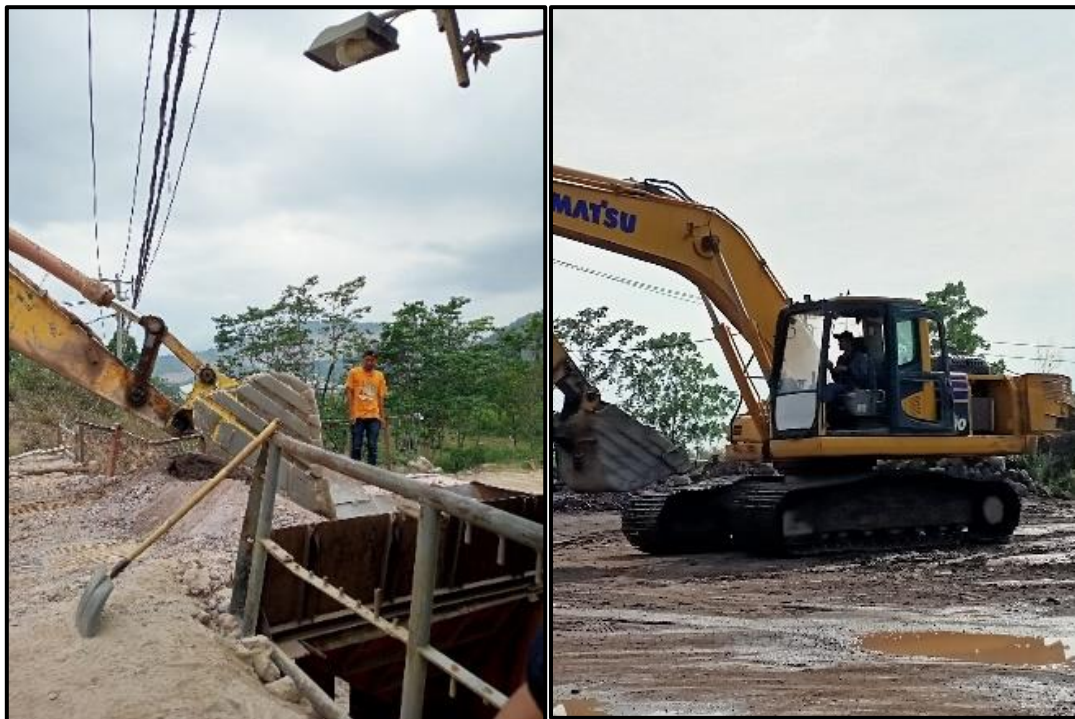
Gambar 2. Helper Tidak Menggunakan APD saat Bekerja
